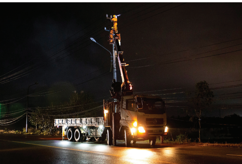
Tổng công ty Điện lực miền Trung huy động nhân lực từ các Công ty Điện lực thành viên tới xử lý sự cố tại Quảng Nam, Quảng Ngãi. Trong ảnh là đội xung kích PC Đắc Lắc thi công tại huyện Núi Thành, tỉnh Quảng Nam trong đêm 30/10
